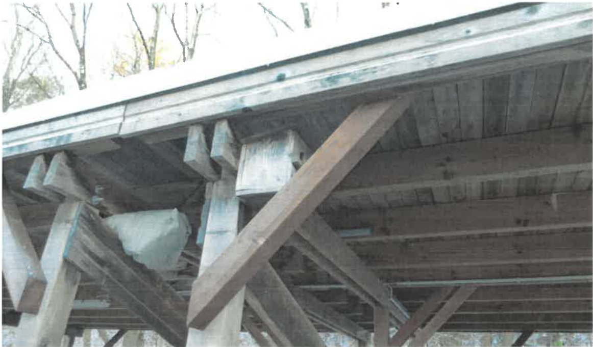
Abbildung 9: Dach und Stützkonstruktion des Carports mit Nistkasten und potenziellen Einzelquartier-Möglichkeiten für Fledermäuse in Zwischenräumen und Spalten an der Dachkante und zwischen Balken und Brettern.
