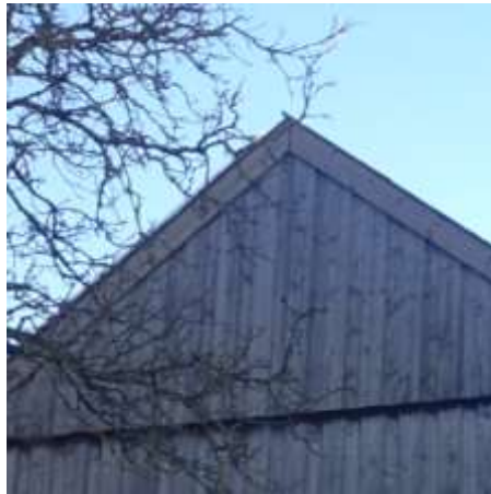
Holzverschalungen und Spalten
